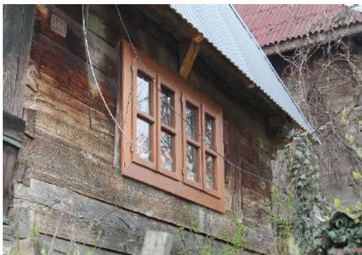
Figura 9. Ferestre cuplate, cu două canate subîmpărțite, cu tâmplărie din PVC cu aspect de lemn
